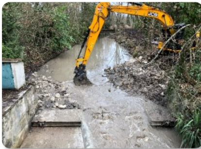
Remise en eau par retrait du batardeau après une période de séchage.
