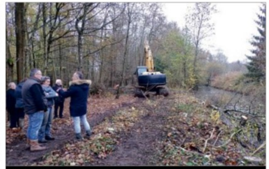
ENVIRONNEMENT. Le technicien de rivière du Syndicat intercommunal de la Bionne, du Cens, de la Crénolle et de leurs affluents a expliqué l'intérêt de ces travaux aux riverains.
