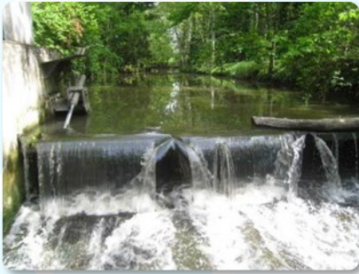
Clapet de Bionne en position haute : rupture des continuités écologiques
