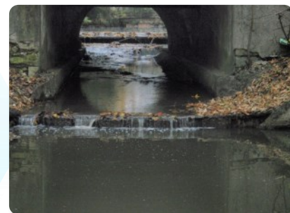
Aval du pont : nouvelle rupture de la continuité piscicole
