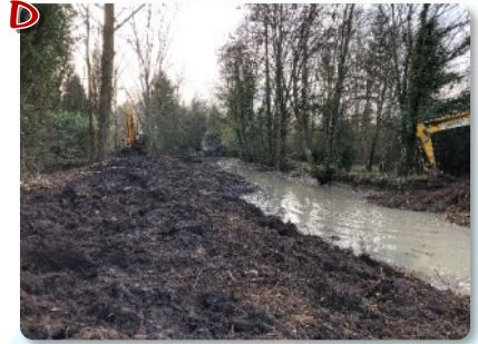
Retalutage des berges sur les deux rives pour retrouver un profil en travers cohérent et créer les banquettes.
