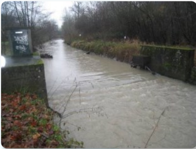
Clapet de la Bédinière période de hautes eaux (clapet abaissé) - rétablissement des continuités écologiques
